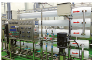
RO(逆浸透)膜システム
