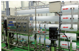
RO（反渗透）膜系统
